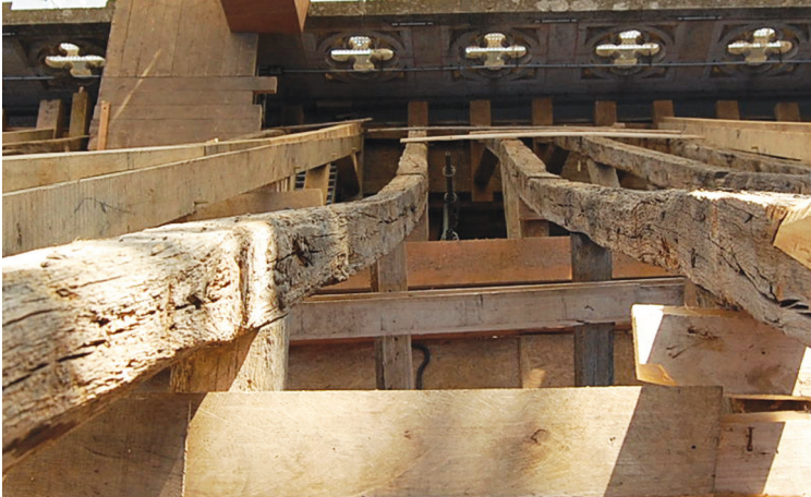
Fig. III-24 &gt; Fléchissement des chevrons de la nef.
