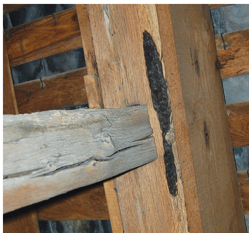
Fig. II-2 > Chevron nord de F52 (vers 1238), trace d'incendie sur l'arête, recoupée par l'équarrissage.
