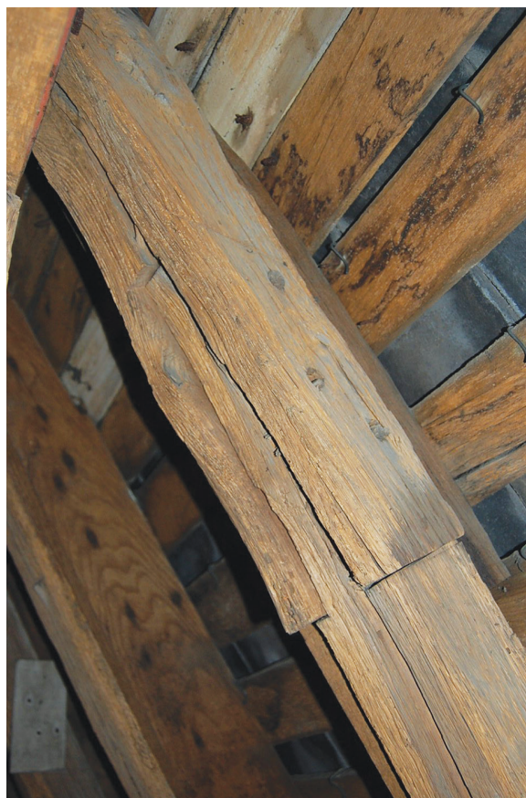
Fig. II-9 > Tête du chevron de F56, greffé en about par un enfourchement chevillé à talons et rives droits.
