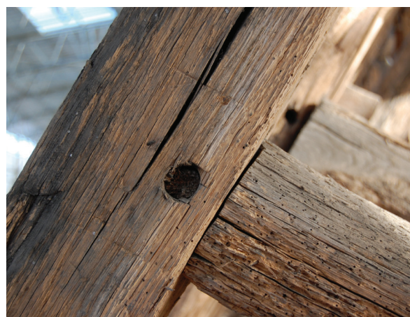
Fig. IV-2 > Tracés de piquage au traceret destiné à délimiter la mortaise à tailler sur le chevron.
