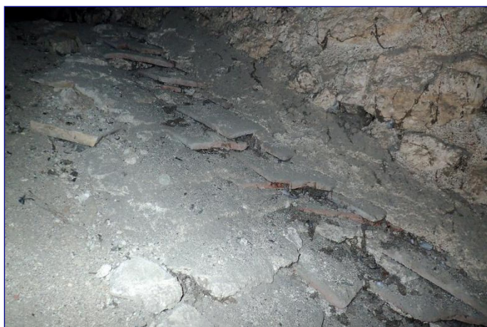
Voûte de la travée droite du chœur, ancien solin posé au contact du pignon ouest, tuiles scellées dans du mortier
