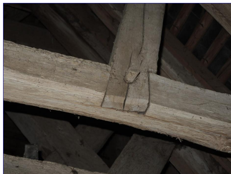
Fig. 9 : charpente de la travée droite, F 1, assemblage à mi-bois avec ergot de la contrefiche
