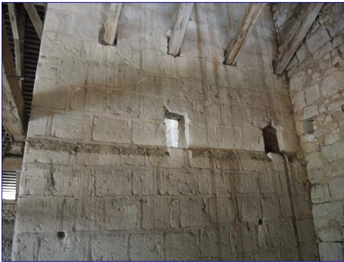
Réserves traversantes sur la paroi nord de la base du clocher
