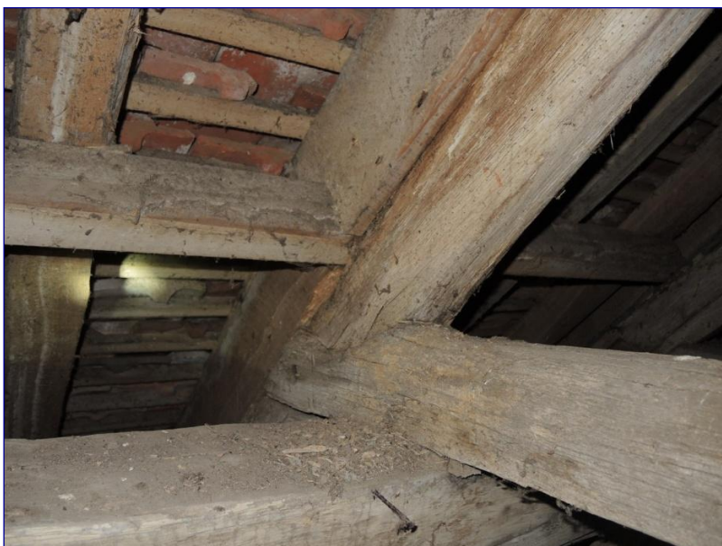
Fig. 9 : charpente de la nef, assemblage à mi-bois entre le second faux-entrait et le chevron
