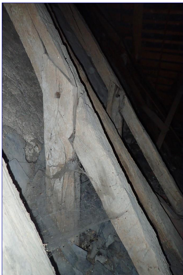
Fig. 12 : charpente du chœur, assemblage à mi-bois jambette/chevron (F6 au 1 er plan, F8 à l'arrière-plan)
