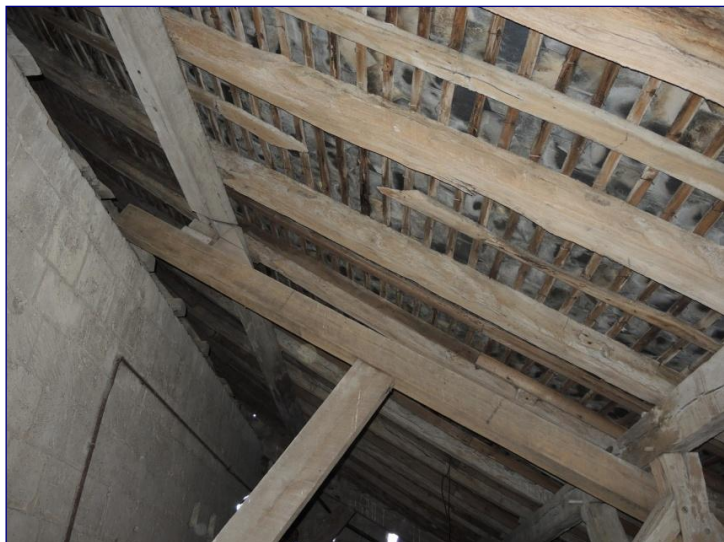
Fig. 13 : chapelle nord, charpente en appentis à chevrons-formant-demi-fermes embrevés en tête dans les chevrons du chœur
