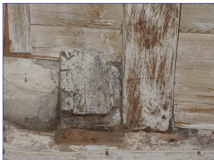
Fig. 5 : charpente de la nef, ancien entrail scié (à gauche)
