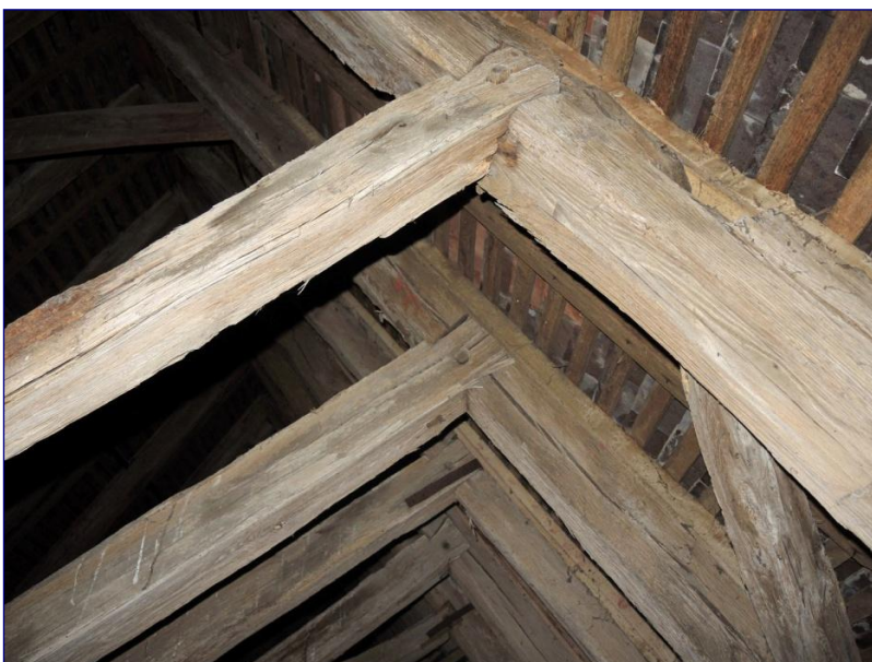
Fig. 7 : charpente de la nef, assemblage à mi-bois des têtes d'écharpes dans les chevrons
