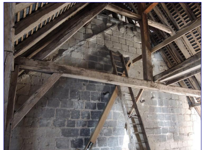
Charpente de la nef, ancien solin de toiture sur le pignon oriental
