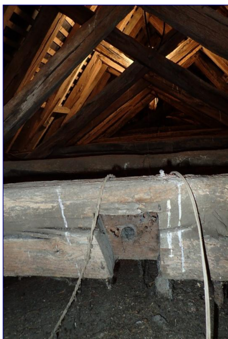
Fig. 10 : charpente de la nef, entaille orpheline d'une suspendente
