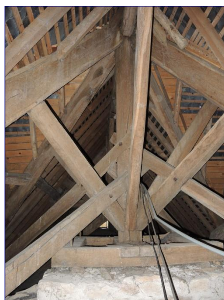
Poinçon à la jonction des charpentes de la nef, du chœur et des bras de transept
