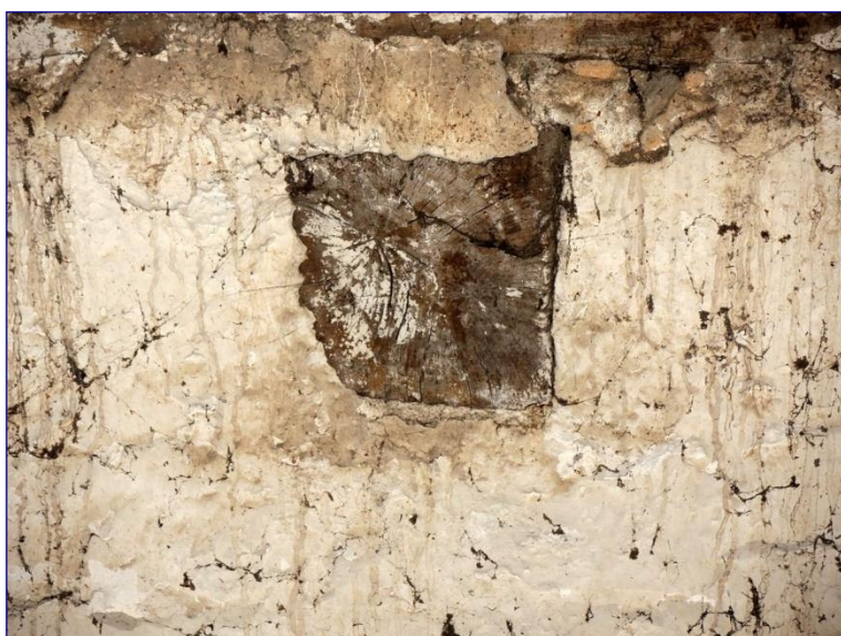
Fig. 16 : charpente de la nef, ancien entrain scié au sommet du gouttereau
