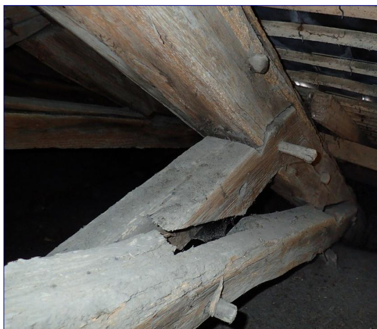
Fig. 9 : charpente de la nef, assemblage à mi-bois de l'entrait retroussé avec l'écharpe
