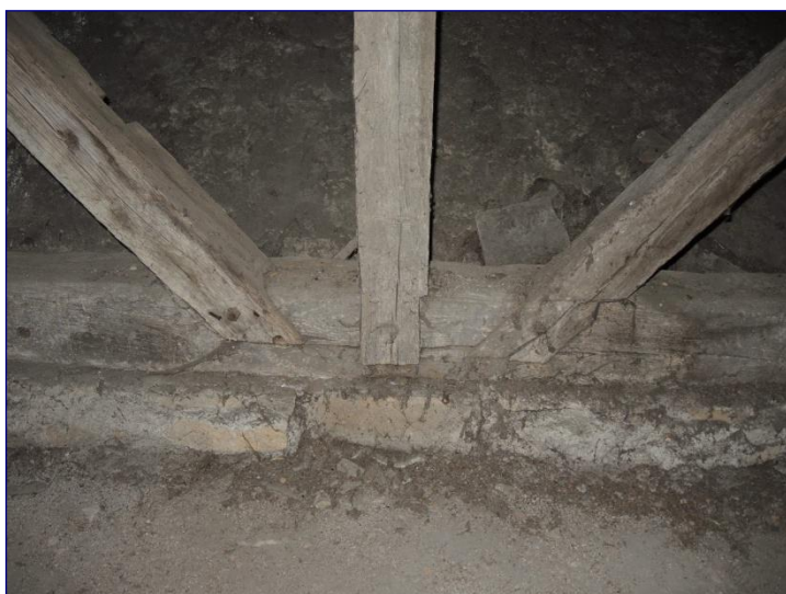
Fig. 9 : charpente de la nef, pan-de-bois longitudinal nord, assemblage à mi-bois du poteau et des décharges du réseau réticulé dans la sablière basse
