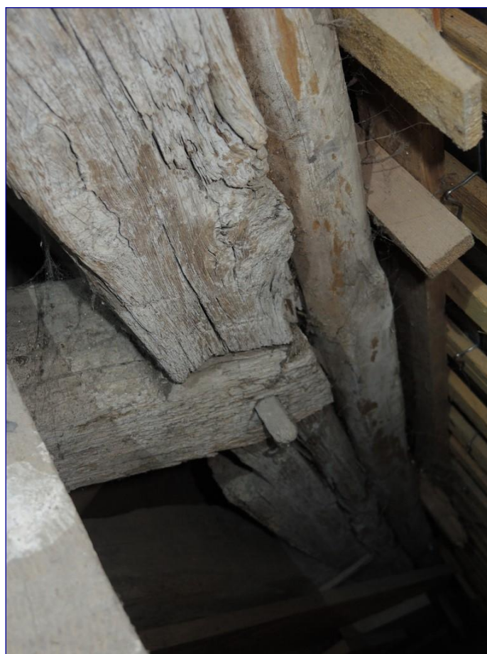
Fig. 5 : charpente de la nef, assemblage à mi-bois avec ergot entre l'entrait retroussé et le chevron
