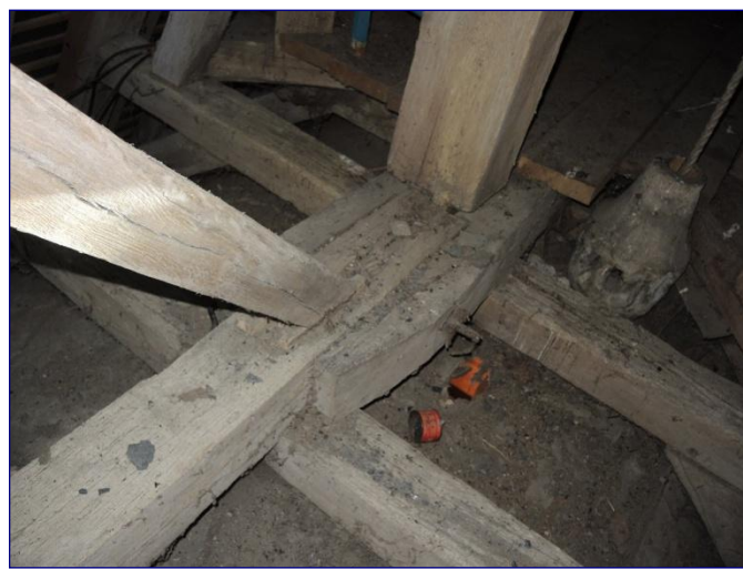
Charpente de la nef, système d'amoises de la sous-faîtière au-dessus des faux-entraits et à l'aplomb du poinçon
