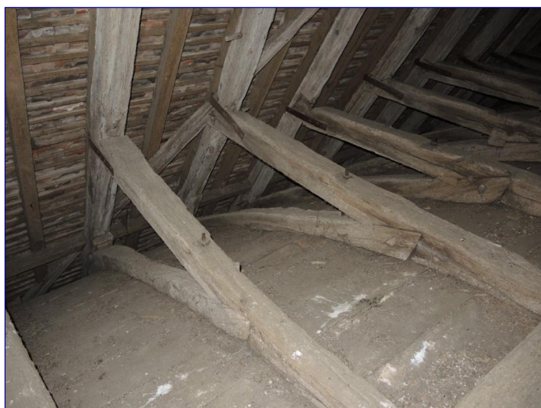
Fig. 11 : charpente de la nef, aisseliers courbes assemblés au 1 er niveau de faux-entraits
