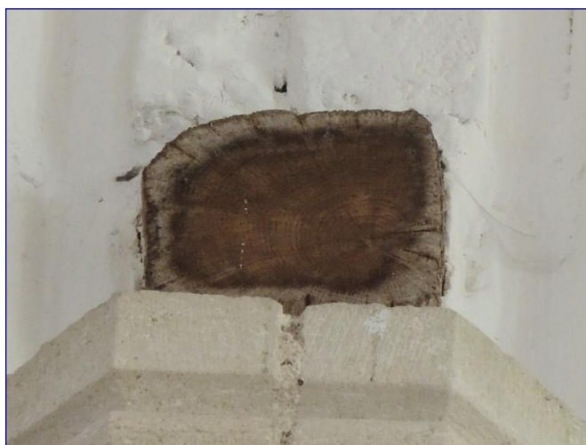
Fig. 7 : pièce de bois sciée au sommet d'une pile du chœur
