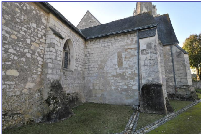
Détail de l'arrachement de l'absidiole sur le bras de transept nord
