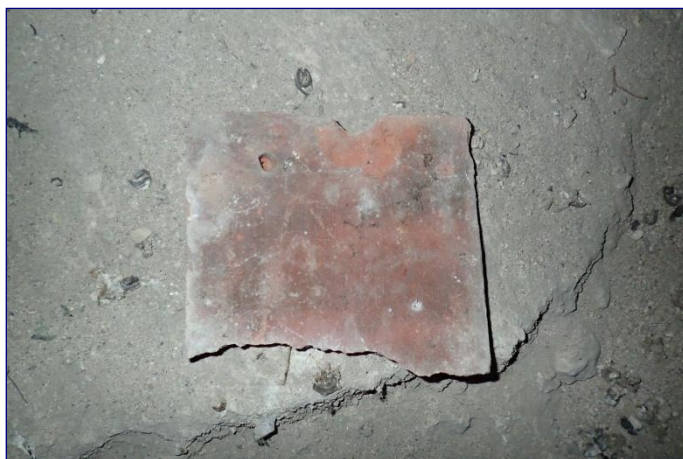
Comble du chœur, fragment de tuile de l'ancien dispositif de couverture sur voûte
