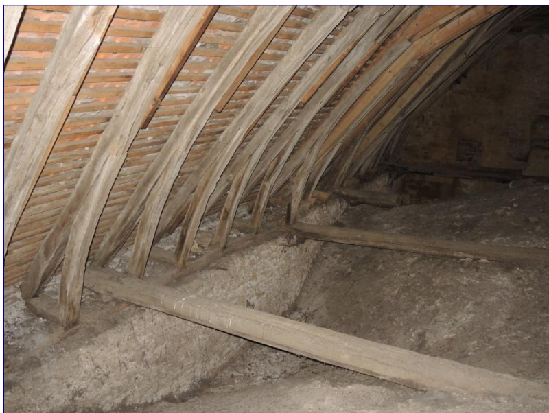
Fig. 8 : charpente occidentale, entrails noyés dans les voûtes ou sciés
