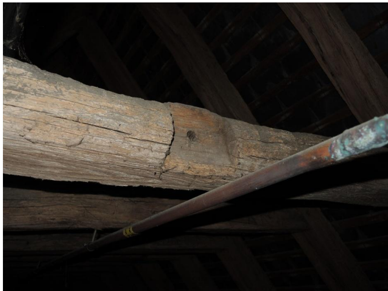
Fig. 10 : charpente du vaisseau principal, structure 1, assemblage à mi-bois pour suspenste sur ferme principale
