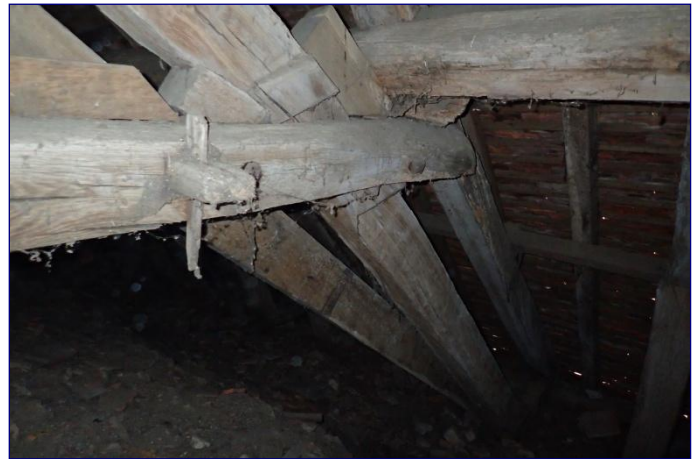
Charpente de la nef, clavette réunissant les moises de l'entrait retroussé
