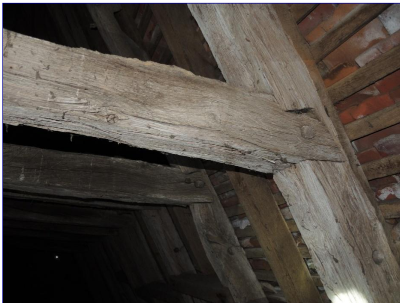
Fig. 12 : charpente de la nef, assemblage à mi-bois entre 2 e faux-entrait et chevron
