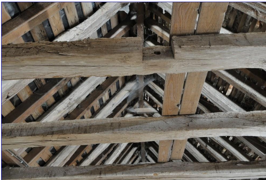
Fig. 10 : charpente de la nef, entaille orpheline pour un faux-poinçon
