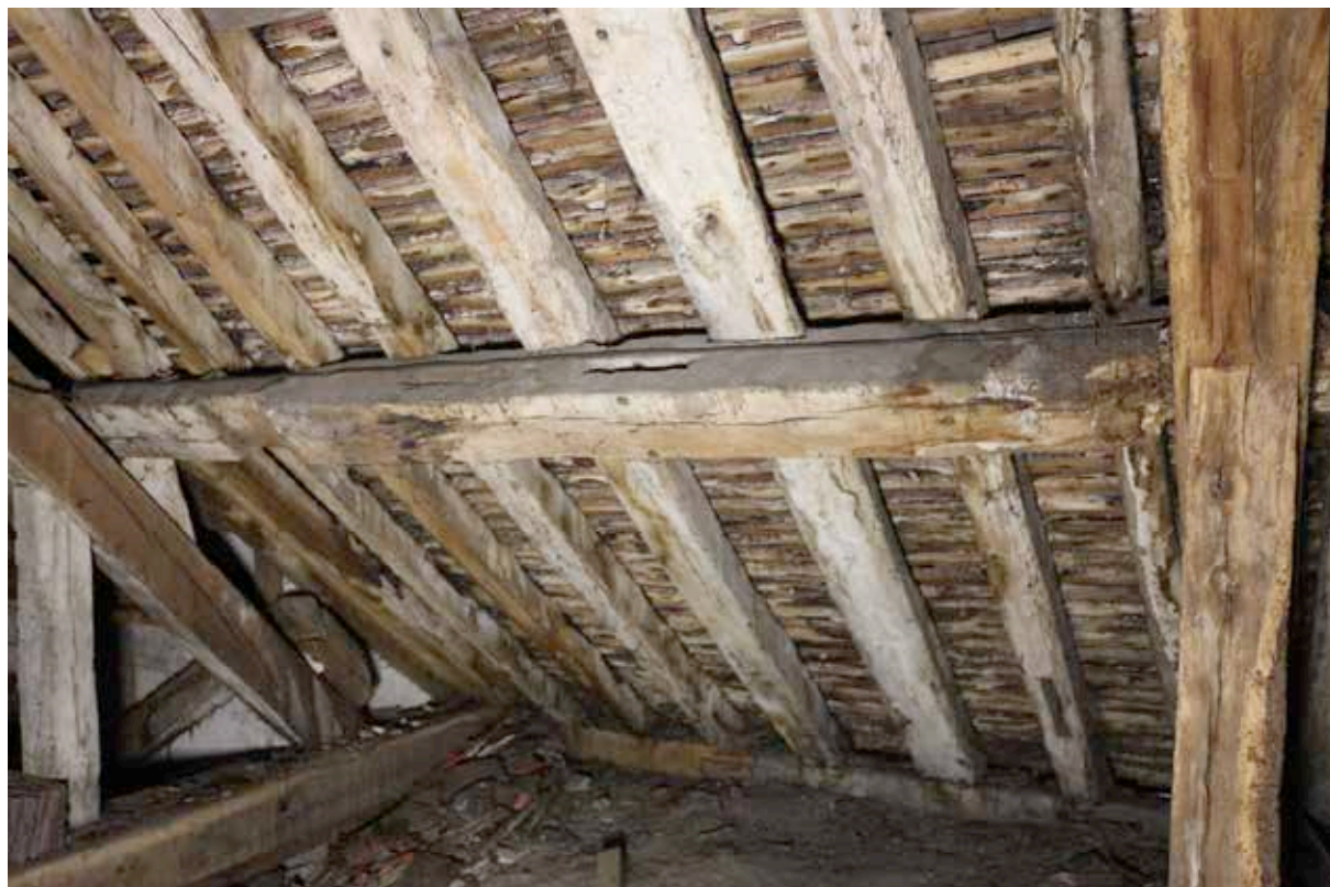
III. 20 — Déambulatoire : dépôt blanc sur les bois (cl. F. Épaud, CNRS).
