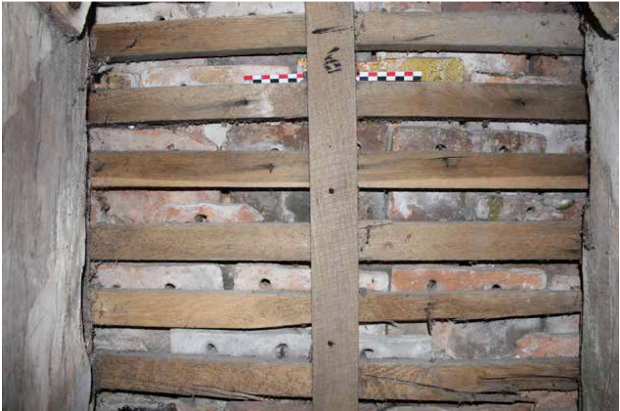
Ill. 63 — Transept nord, versant ouest (sondage 6) : tuiles médiévales sans crochet parfaitement identifiables en sous-face de la couverture (cl. S. Aumard, CEM).
