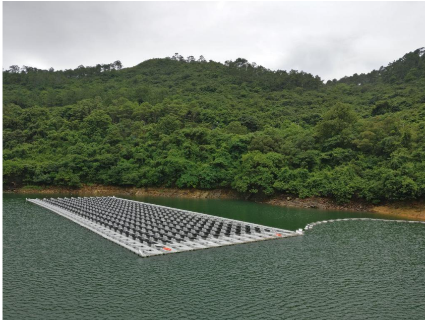
FIGURE 5.1 – Usine flottante de production d'énergie solaire - Shek Pik, île de Lantau
