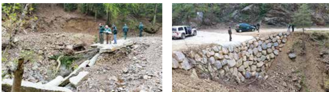
Photos 3 et 4 : en FD des Orb (34), dégâts aux routes forestières et recalibrage d'ouvrage : radier et enrochement
