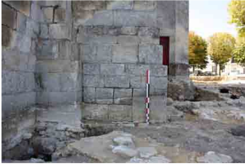
A - ES 3, élévation de la reprise en sous-œuvre UA 8023, depuis l'est (F. Mandon)
