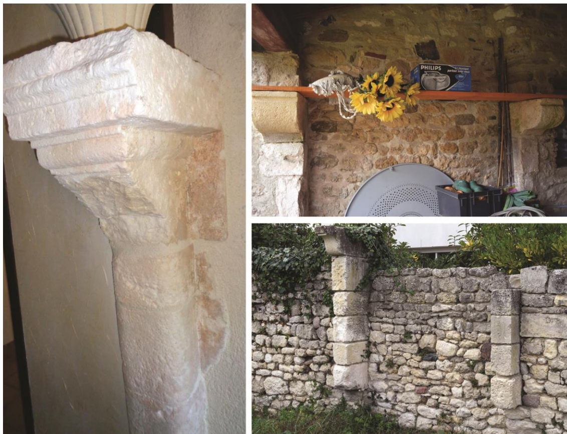
Fig. 4 : 7 rue de la Grotte (à gauche) ; 13 rue du Port (en haut à droite) ; îlot 6 parcelle b913 (en bas à droite). Photographies C. Hubin/M/ Duc
