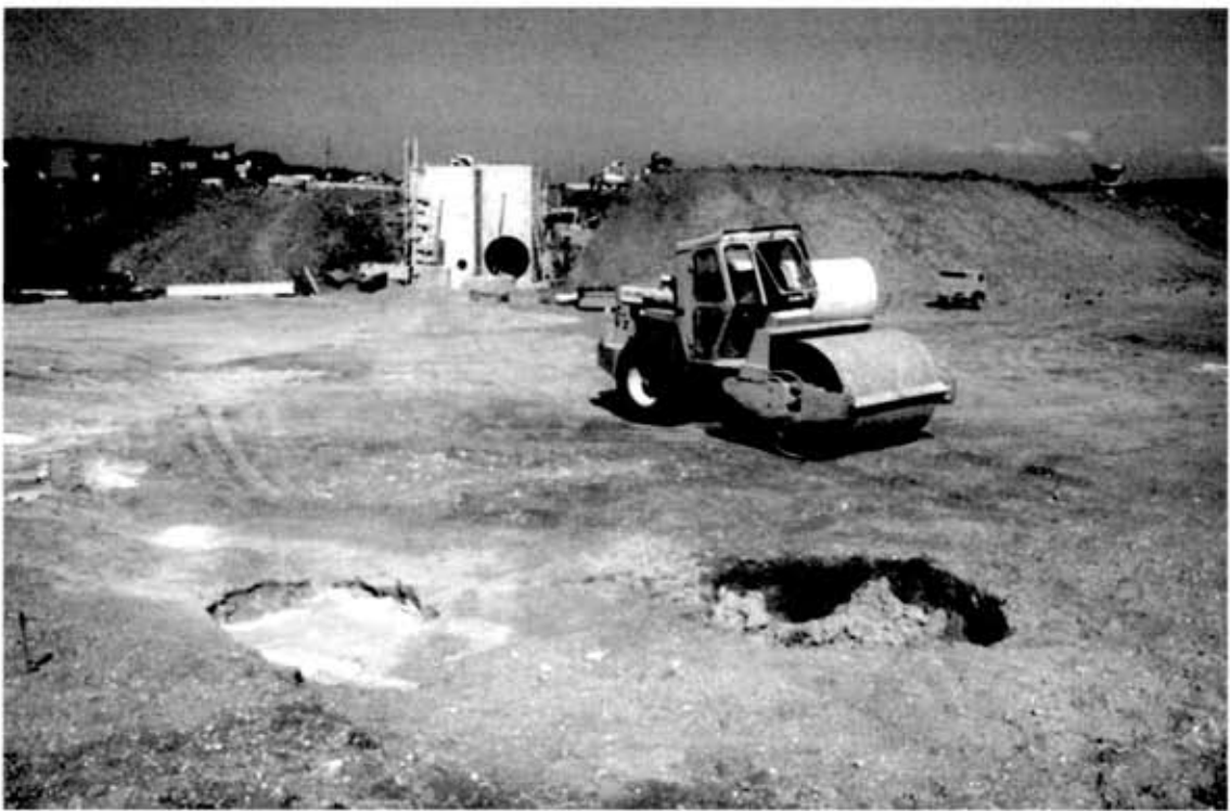
Figure 8 - Soutirages lors des travaux de construction de l'A75. Ils manifestent une réactivation des cavités sous-jacentes suite à l'excavation d'une partie de la couverture d'altérites.
