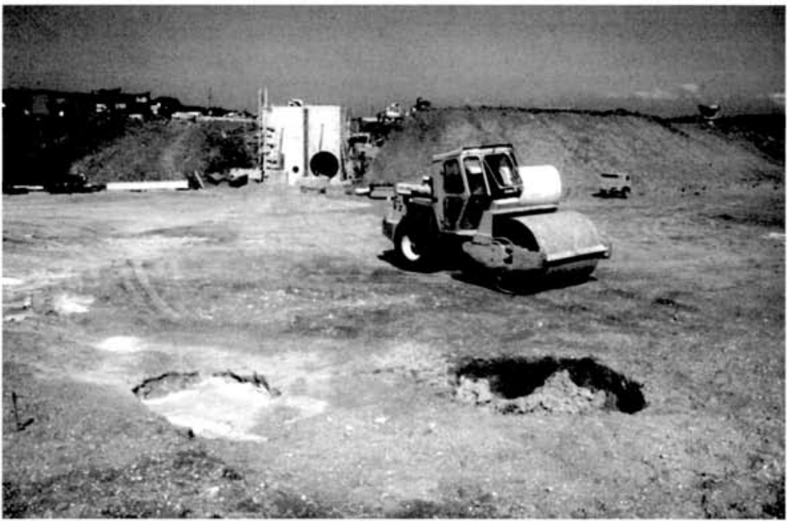
Figure 8 - Soutirages lors des travaux de construction de l'A75. Ils manifestent une réactivation des cavités sous-jacentes suite à l'excavation d'une partie de la couverture d'altérites.
