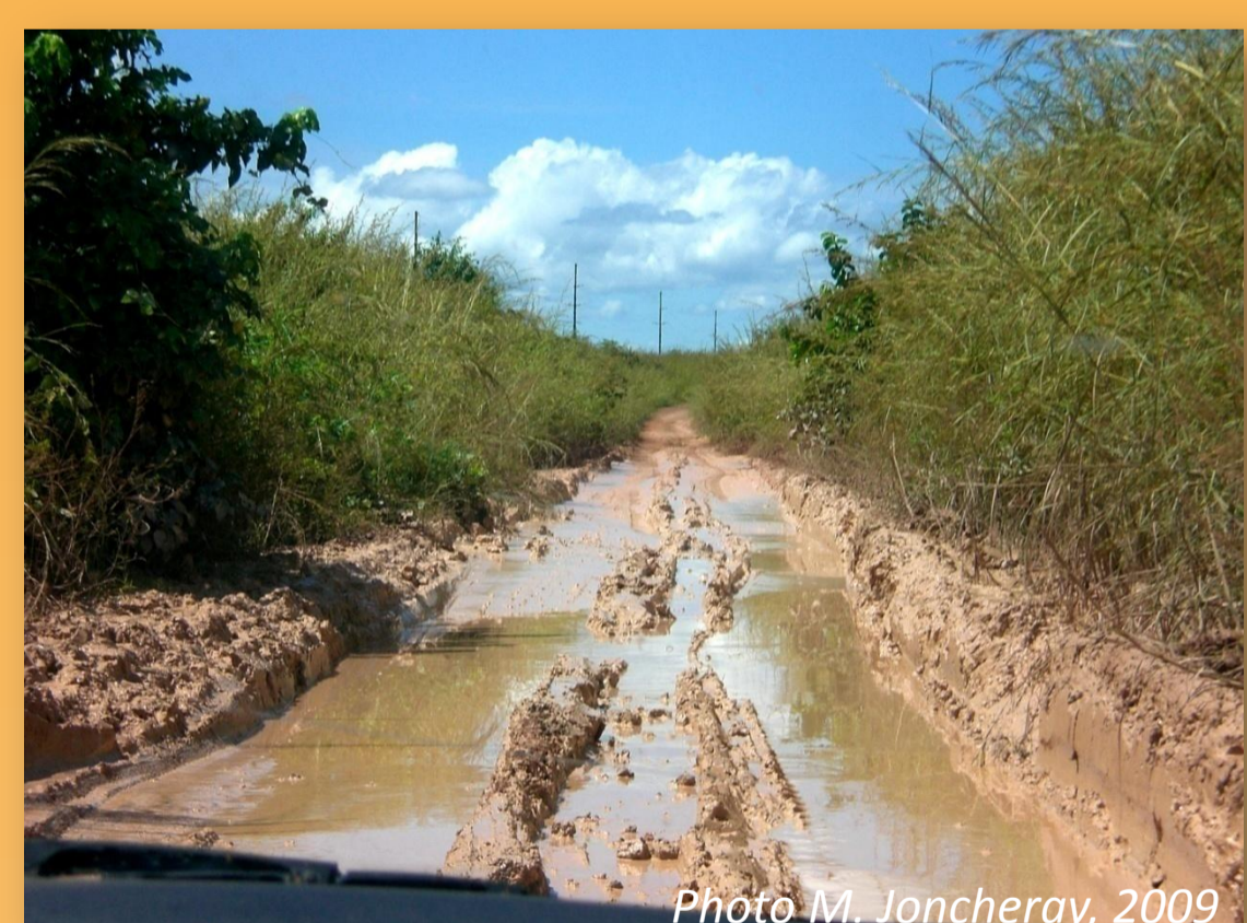
La RN1 avant sa rénovation était inondée quasiment en permanence durant la saison des pluies. Cette portion de route entre Bouansa et Loutété, presque infranchissable, illustre les difficultés de circulation des hommes comme des marchandises.
