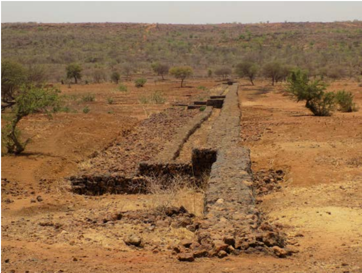
Seuil d'épandage, site de Karkara, Photo prise, le 24 avril 2017 à 12h53
