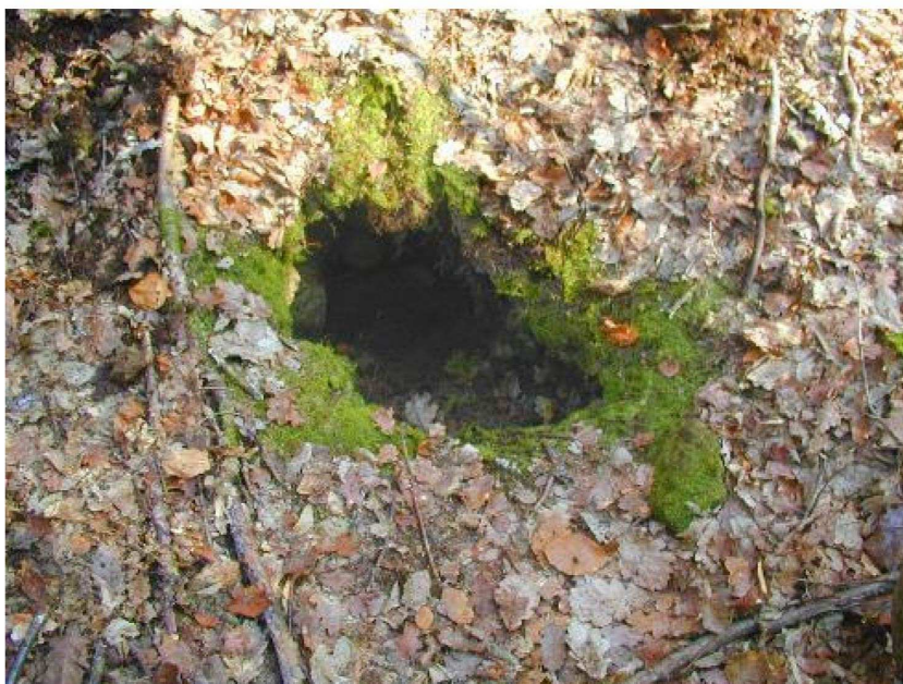
St007001011, effondrement partiel de la voûte de l'aqueduc de Montjeu, vu vers l'est (L.B.)
