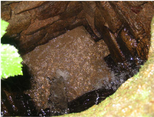
St007002001, vue intérieure d'un captage moderne en amont de la mère fontaine (L.B.)
