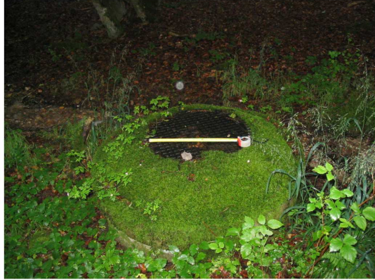
St007002001, détail d'un captage moderne en amont de la mère fontaine (L.B.)
