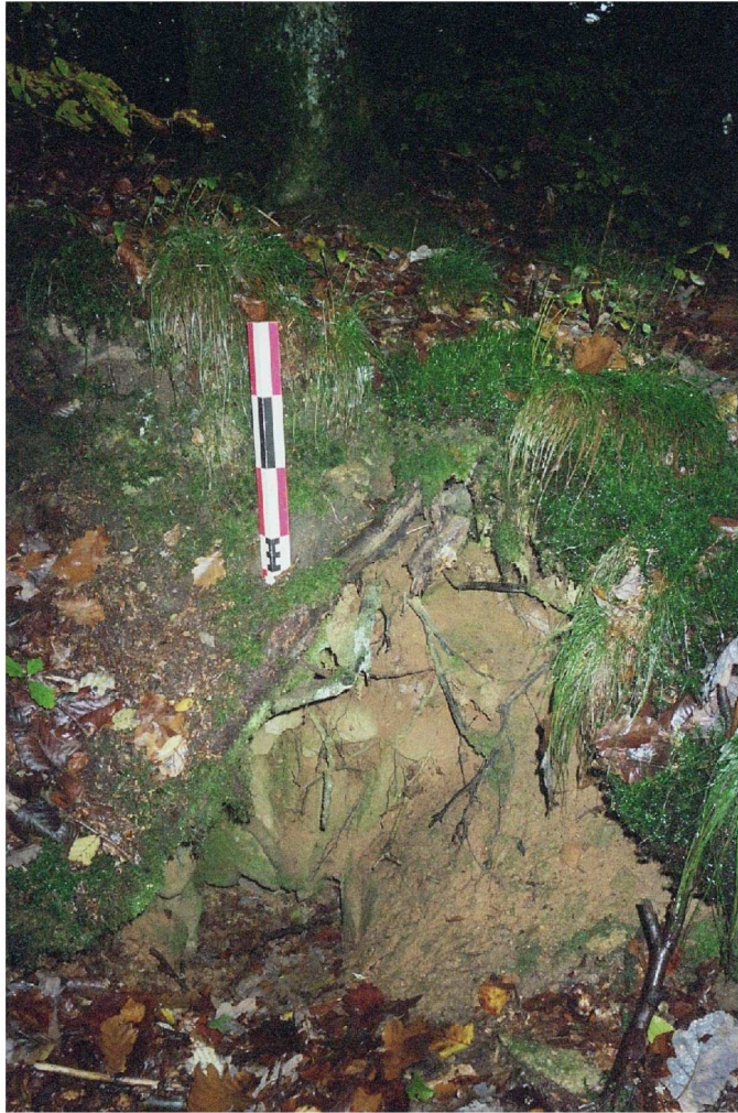
St007001010, effondrement partiel de la voûte de l'aqueduc de Montjeu, vu vers l'est (L.B.)
