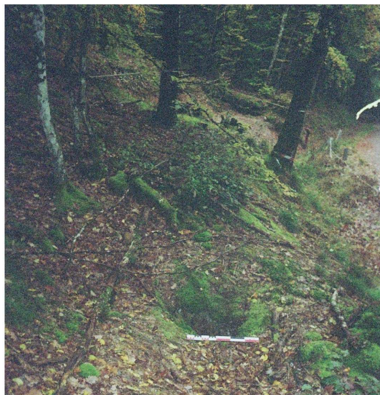
St007001004, effondrement partiel de la voûte de l'aqueduc de Montjeu, vu vers l'est (L.B.)
