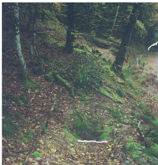
St007001004, effondrement partiel de la voûte de l'aqueduc de Montjeu, vu vers l'est (L.B.)
