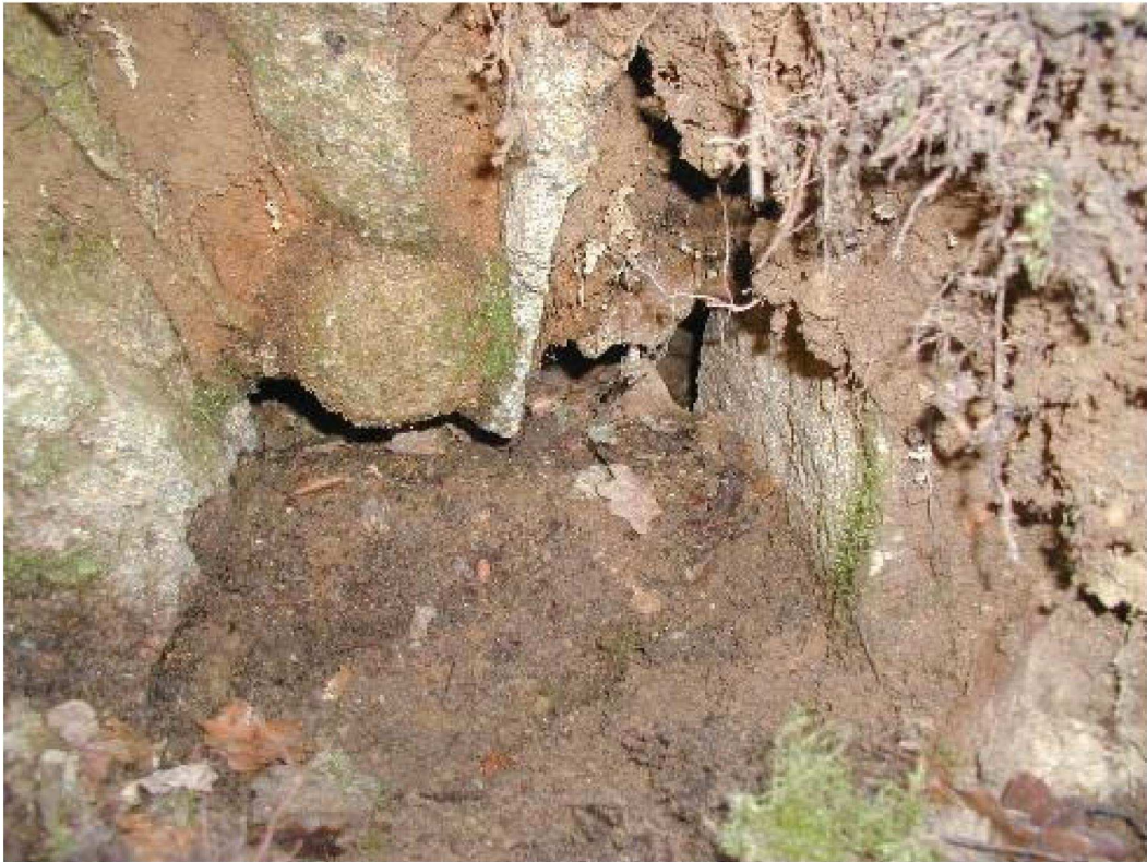
St007001007, effondrement partiel de la voûte de l'aqueduc de Montjeu, vu vers l'est (L.B.)
