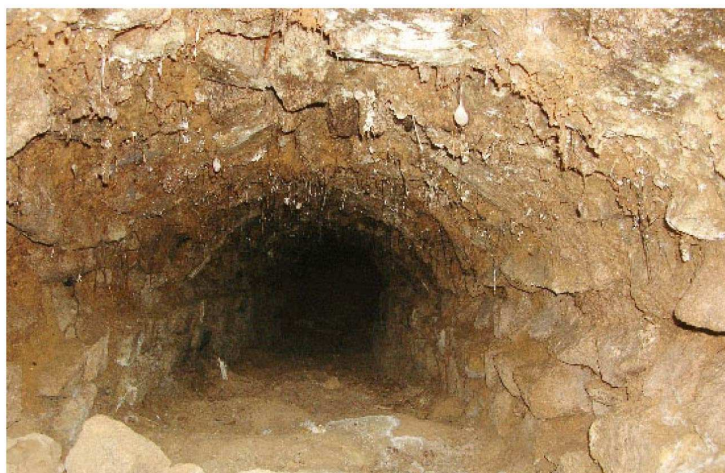
St007001025, intérieur de l'aqueduc, à partir de l'effondrement, vue vers l'est (L.B.)
