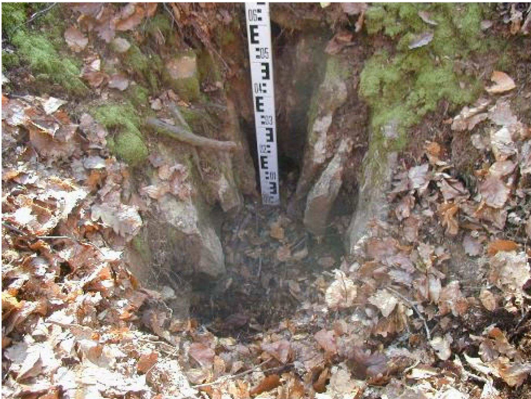
St007001009, effondrement partiel de la voûte de l'aqueduc de Montjeu, vu vers l'est (L.B.)
