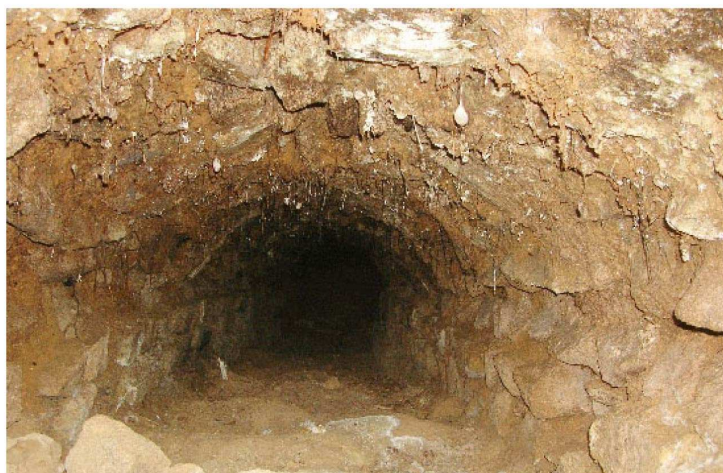
St007001025, intérieur de l'aqueduc, à partir de l'effondrement, vue vers l'est (L.B.)
