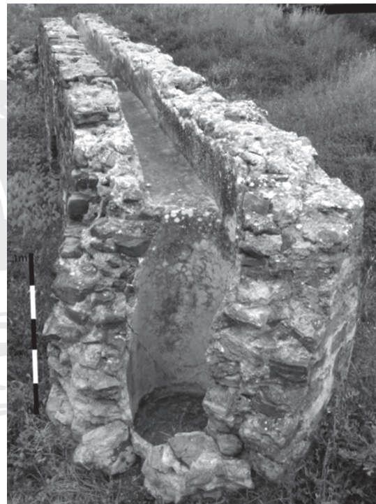
Fig. 10. Puits de rupture de pente en amont du pont Chorrera de l’aqueduc de Punta Paloma (cl. L. Borau).
