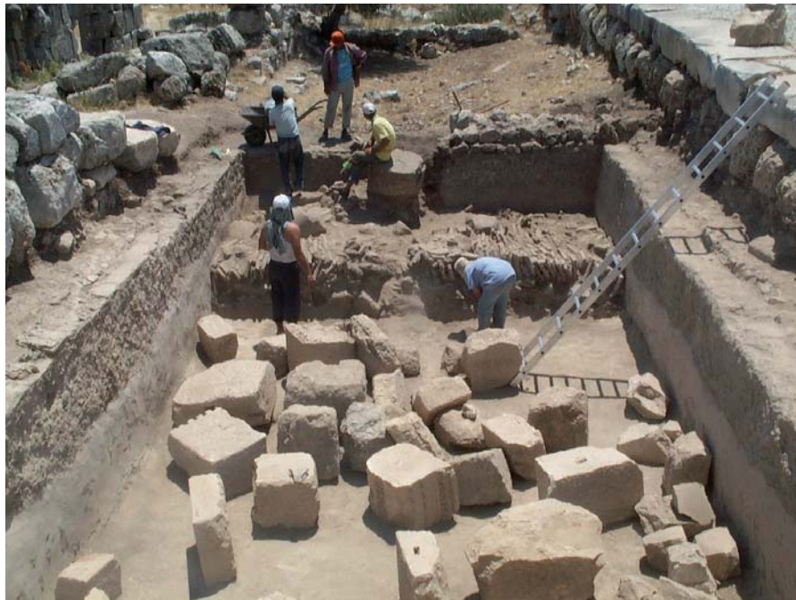
Fig. 9. Blocs précipités dans la citerne lors de l'effondrement de la basilique.
