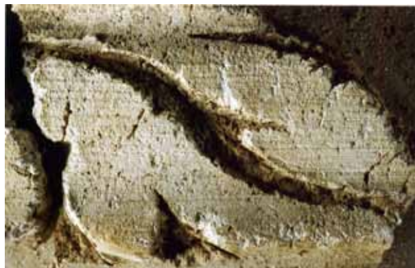
Fig. 12. Détail de la corniche sommitale, motif travaillé au couteau par évidement (photo Cl. Vibert-Guigüe, CEPMR).
