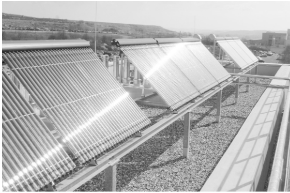
Exemple de solaire thermique avec des tubes sous vide. La température maximale peut être de l'ordre d'une centaine de degrés.
