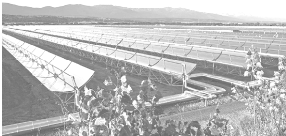
Champ solaire avec concentrateurs paraboliques
