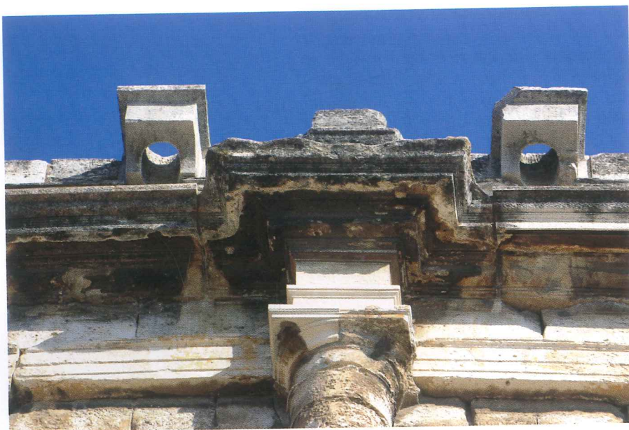
Fig. 4 : Consoles de soutien des mâts du vélum des arènes de Nîmes. (cliché Ph. Fleury).
