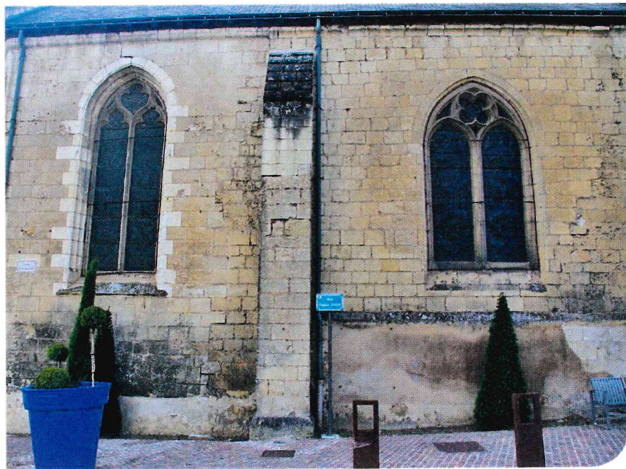
(Fig. 2) Mur goutterot sud. ◻
