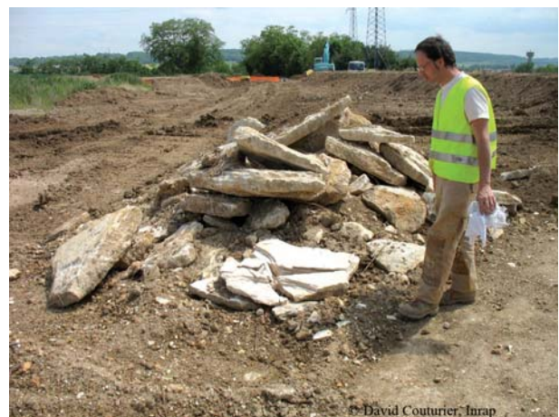
Fig. 12 : Les dalles calcaires extraites du sous-sol par les terrassements liés aux travaux (© David Couturier, Inrap).
