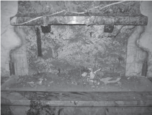
Fig 12. Les techniques de fixation des pilastres : l'utilisation de carrés en fer forgé scellés dans la maçonnerie. État après dépose des bases en bronze.
