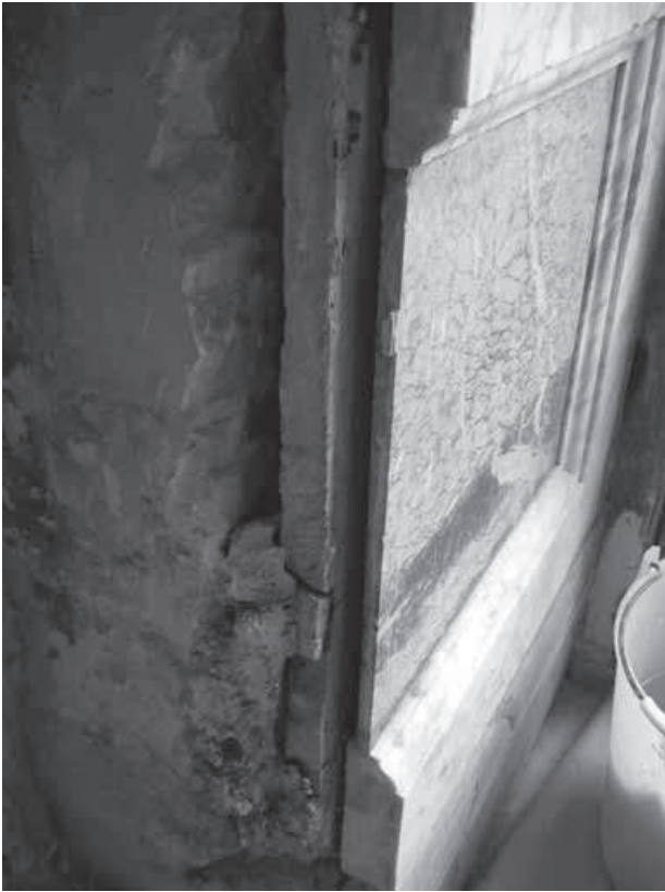
Fig. 11. Les techniques de fixation des panneaux de marbre de la galerie des Glaces : l'utilisation de cales en bois ou plots en plâtre.
