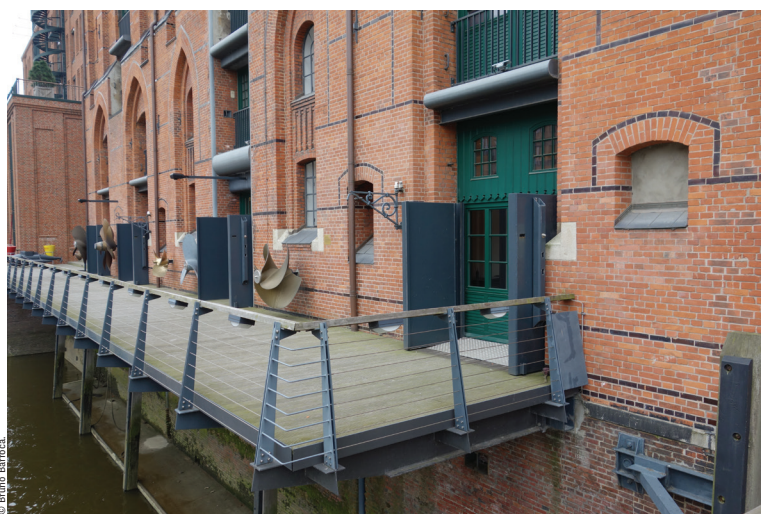
Exemple de mesures de prévention : protection « anti-crues » ouvertes - Musée maritime de Hambourg.
