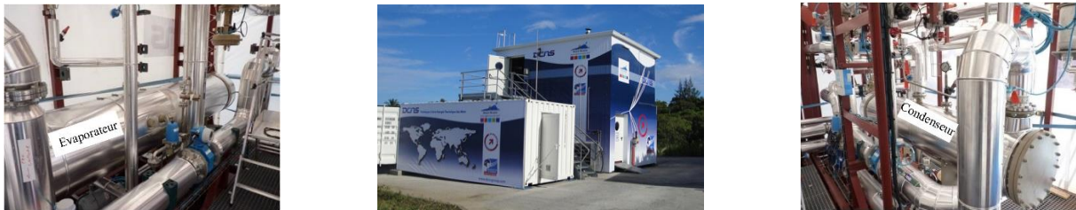
Figure 2 : Installation du prototype à terre, évaporateur (à gauche), vue extérieure d'ensemble (au centre) et condenseur (à droite).
