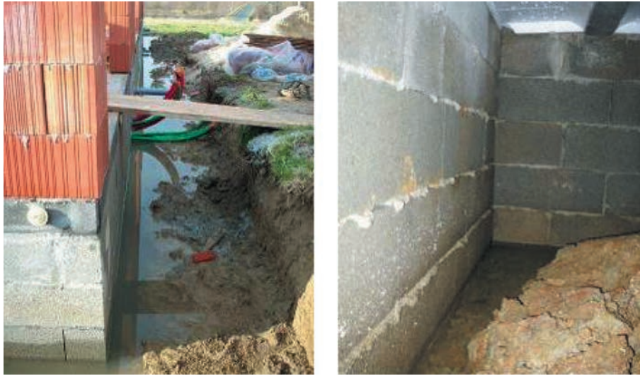
Figure 4 Stagnation des eaux à l'extérieur (gauche) et à l'intérieur (droite) (Source Socabat)
