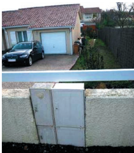
Figure 16 Situation classique d'une maison construite en contrebas du compteur électrique de la route d'accès (Source Socabat)
