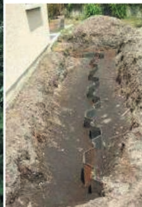
Figure 27 Écran métallique (Source Socabat)
