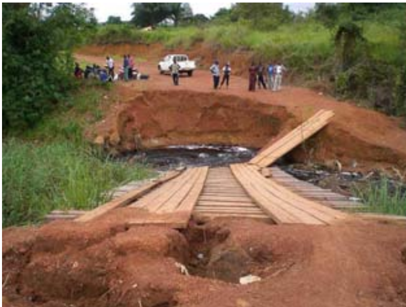
Photo 7 : Le pont de Moutembesse, avant d'arriver à Kingoué s'est écroulé et isole totalement le nord du district
