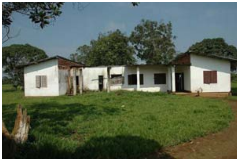
Photo 11 : Une partie des bureaux de la Préfecture de Kingoué n'a jamais été réhabilitée
