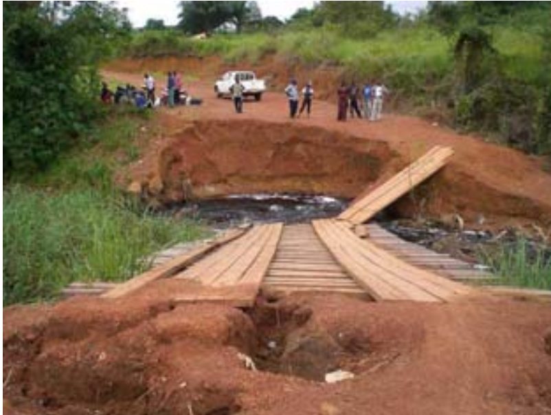
Photo 7 : Le pont de Moutembesse, avant d'arriver à Kingoué s'est écroulé et isole totalement le nord du district
