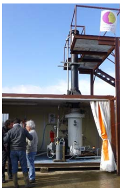
Fig. 2 EPUROGAS sur site
