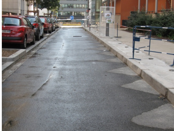
Figure 1 : Humidification de la chaussée, rue de la Buire (2012)
