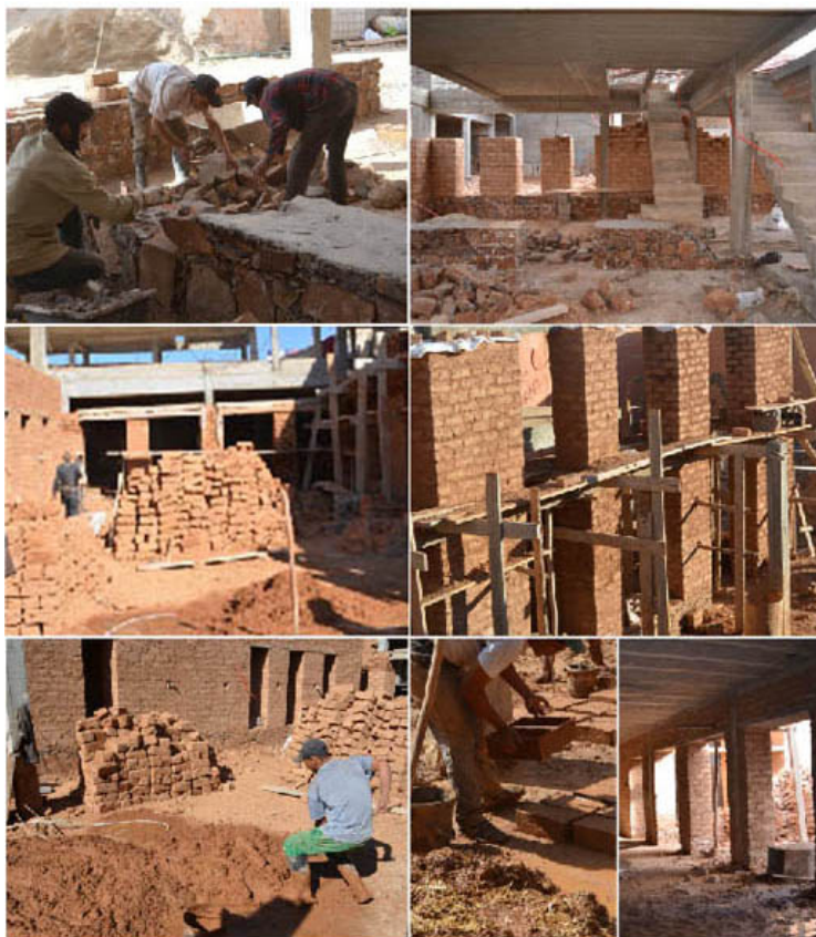
Figure 19 : Work in progress, le bâtiments en cours de construction : pierres de soubassements sur structure partielle en béton armé, adobes pour les parois pour une épaisseur permettant une bonne isolation thermique (60 à 80 cm), Salima Naji ©.
