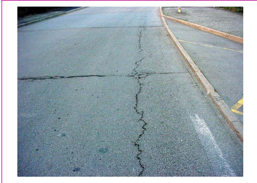
□ Figure 1 Exemple d'une chaussée semi-rigide fissurée.
