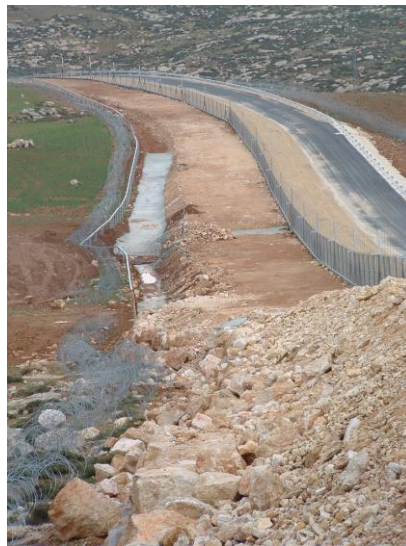
Photo 1. Portion de la barrière de séparation en construction, Sud de Samu' (Cisjordanie 2006). Cliché : Cédric Parizot
