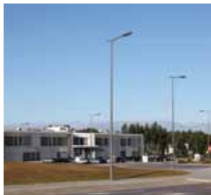
Vila Nova de Gaia, éclairage de la VL6 - São Félix da Marinha avec des stabilisateurs-réducteurs de flux lumineux en tête de ligne et l'illumination de la rue Conselheiro Veloso da Cruz avec des stabilisateurs-réducteurs de flux lumineux de "point à point" (à droite)
