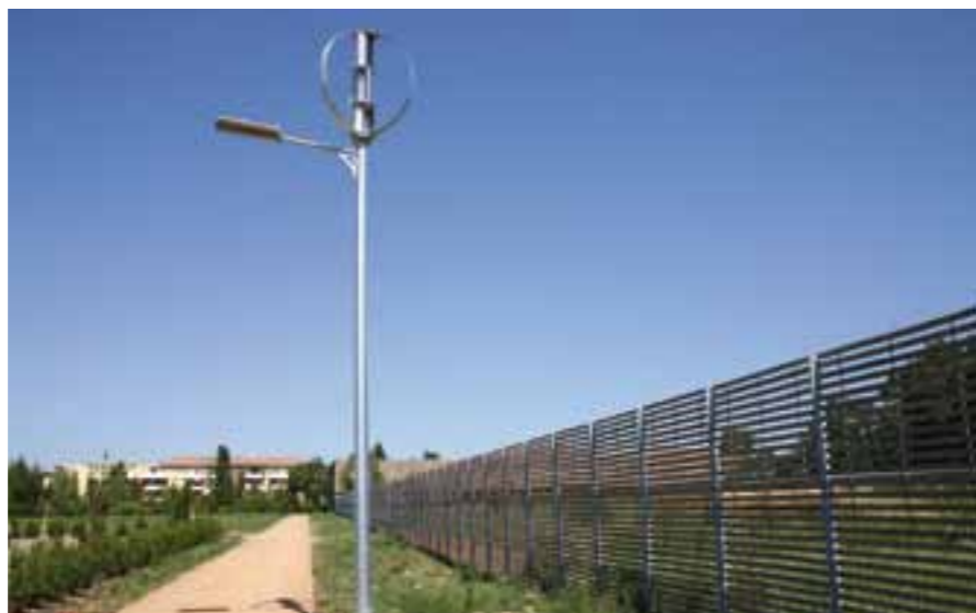
Toulouse. Lampadaires avec énergie éolienne public de Borderouge
