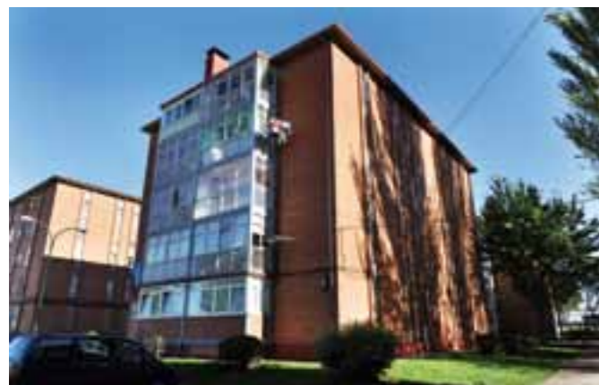
Les façades des immeubles du quartier présentent des pathologies importantes qui affectent l'efficacité énergétique de ceux-ci et la qualité de vie des habitants
