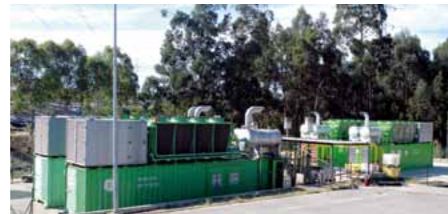
Vila Nova de Gaia. Utilisation de biogaz issus de sites d'enfouissement de production d'énergie électrique et thermiques de Suldouro
