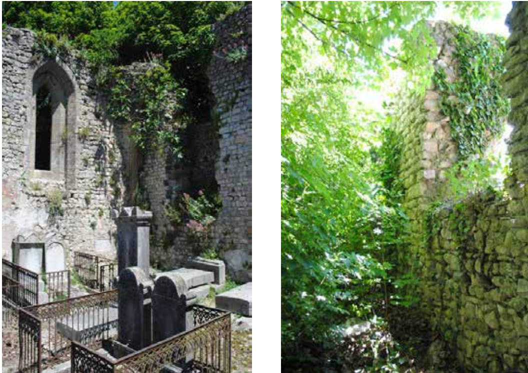
Fig. 7 et 8. Vue des parements internes et externes envahis par la végétation.
