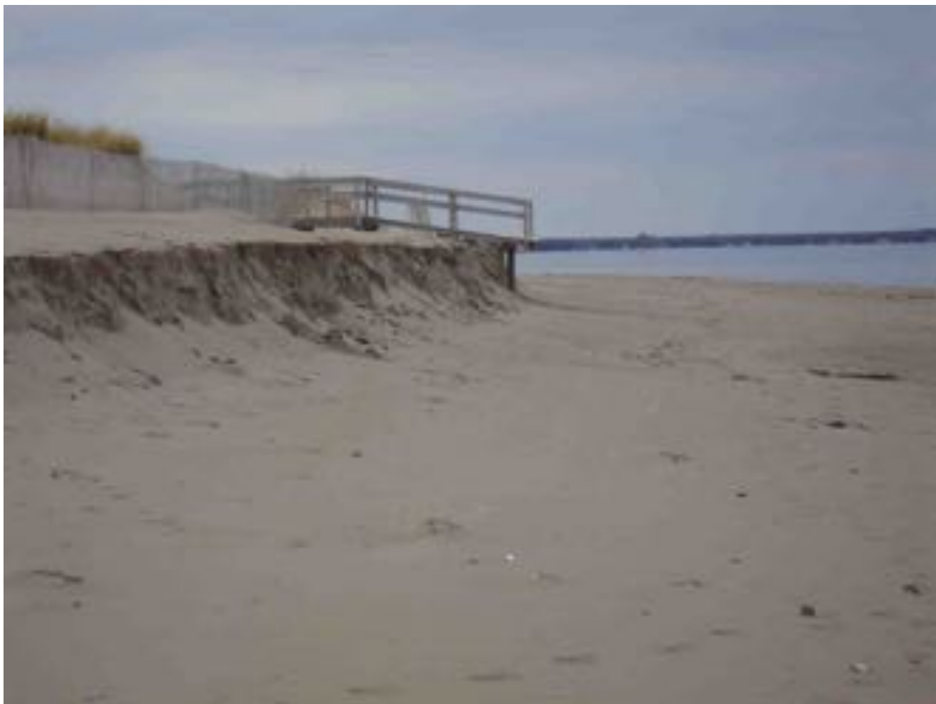
Figure 10. Érosion à la plage Parlee. Source: Photo S. Weissenberger, 2011
