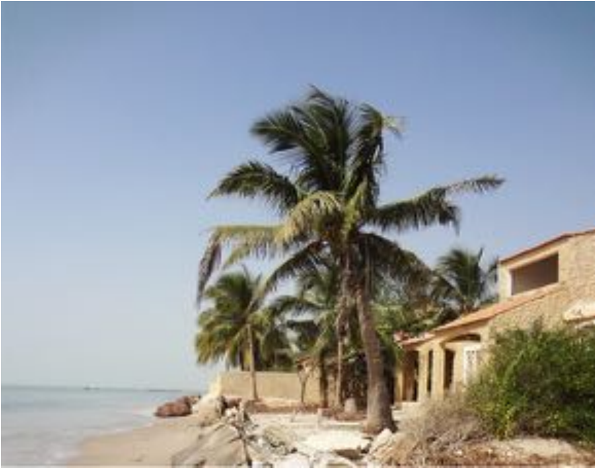
Figure 4. Une maison menacée à Joal. Source : Photo M. Noblet, 2012
