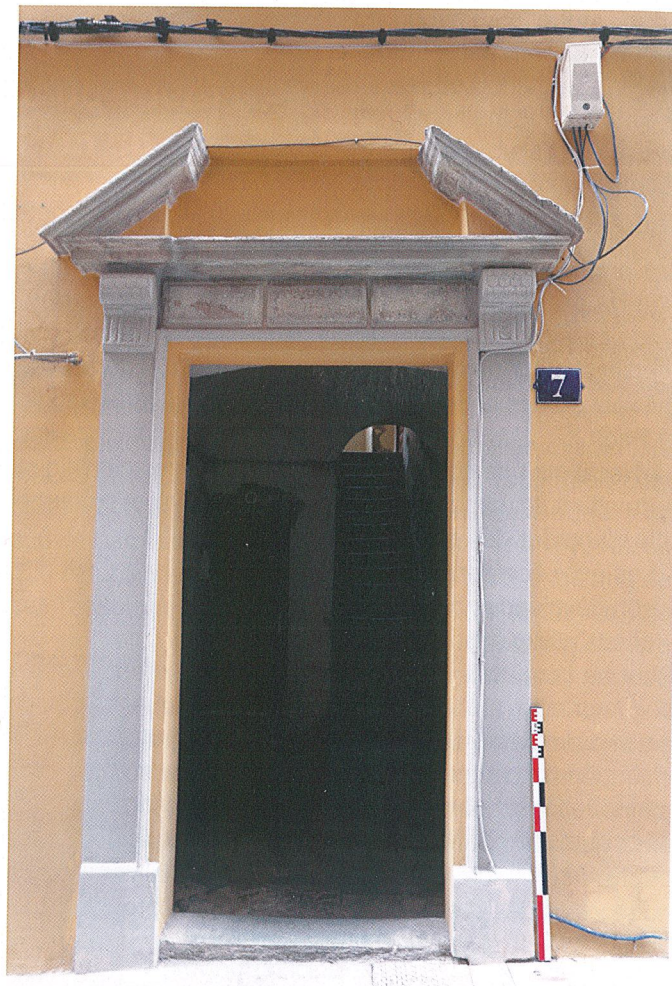
Fig. 29 – Bastia, bâti historique du centre ancien : porte restaurée surmontée d'un fronton ouvert portant la date de 1629 (Arkémine).
