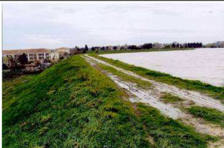
Figure 3 : Digue rive droite de Fourques en limite de surverse lors de la crue de décembre 2003 (crédit photo : Paul Royet – Irstea).
