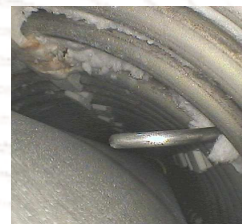
instrumentation du four
