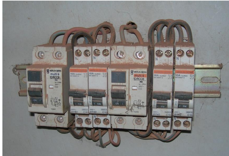
Figure 1 : Appareillages de protection soumis à de fortes contraintes (Ouagadougou).
