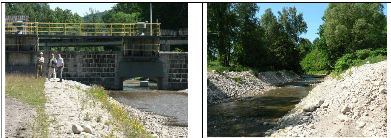
Figure 14 : Barrage à pertuis ouvert de Myslakowice (PL) : à gauche : vue du parement amont ; à droite, photo prise du même point en regardant vers l'amont : sédiments grossiers résiduels dans la cuvette. La comparaison entre le pertuis et les dimensions du lit montre que l'on se trouve en situation de « pertuis étroit ».
