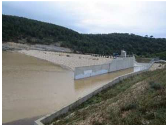
Figure 7 : Le barrage de Saint Génès en train de déverser en octobre 2014
