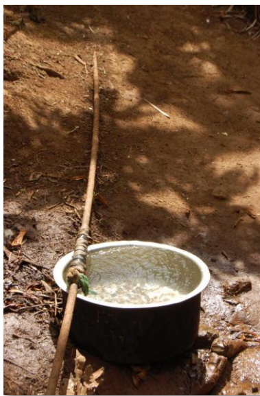
Photo 13 : Fuite d'eau (pas perdue pour tout le monde) sur le réseau d'eau d'Outsa
