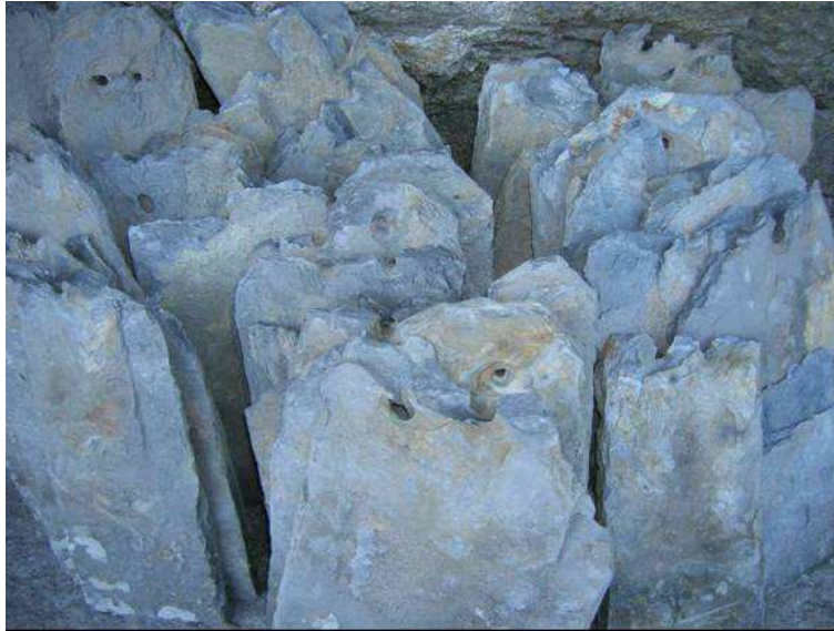
Figure 2. Aspect des ardoises dégradées
