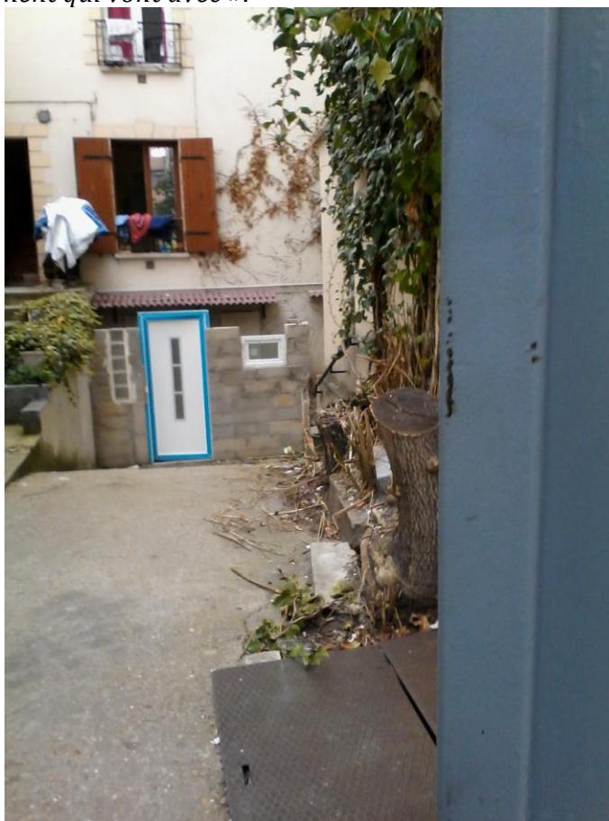
Montreuil 2016 – travaux de transformation sans autorisation d'un garage en logement
