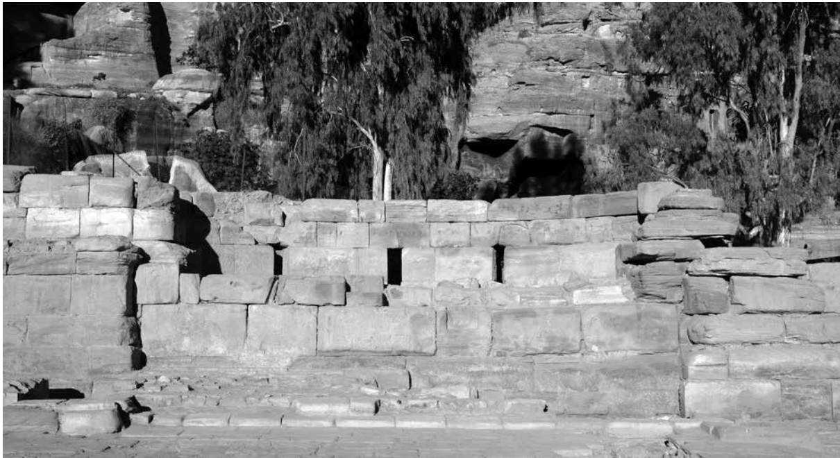
Figure 7.5. Le monument impérial à abside : détail constructif des périeurs de l'abside © MAFP.
