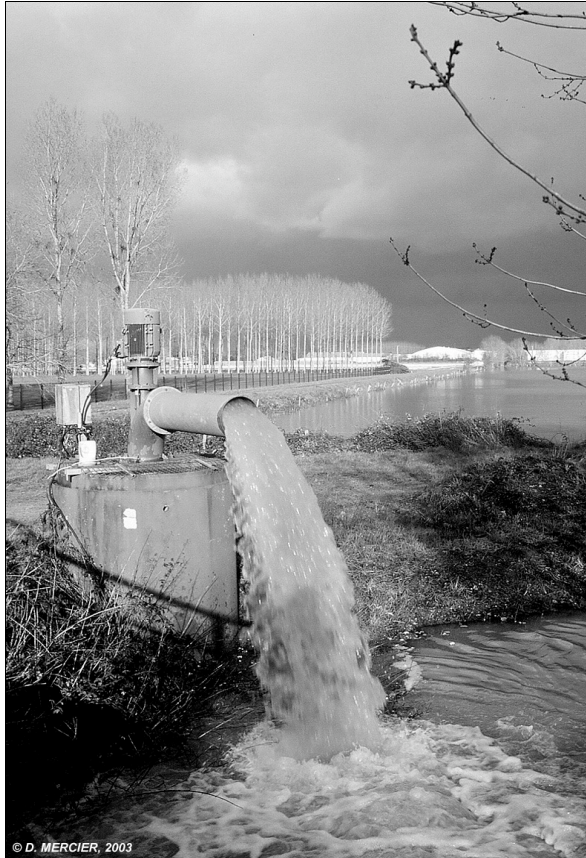
Photo 11 : Les pompes de drainage
