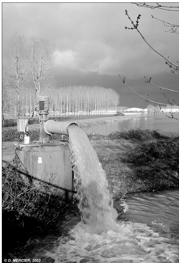
Photo 11 : Les pompes de drainage
