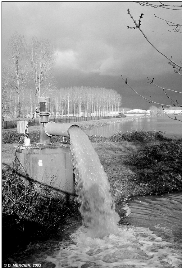
Photo 11 : Les pompes de drainage
