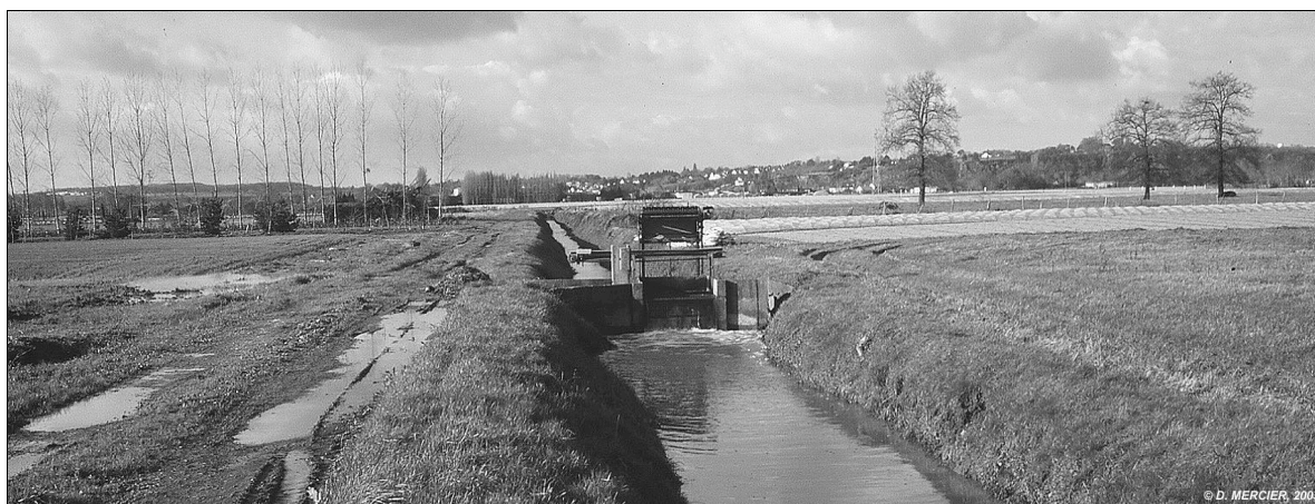
Photo 10 : Le drainage du Val nantais
