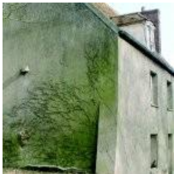
Biocolonisation des façades
