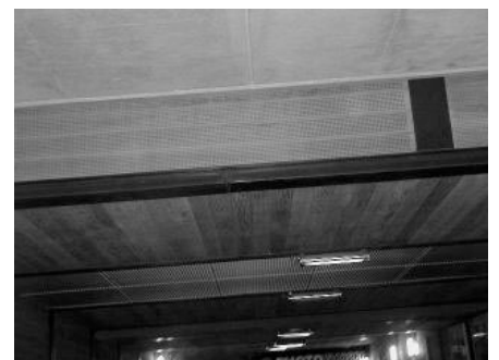
Zoom sur une des caisses absorbantes au plafond
