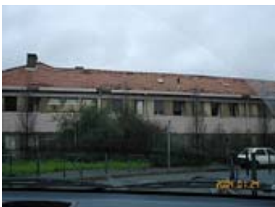
Le bâtiment de l'AFPA endommagé
