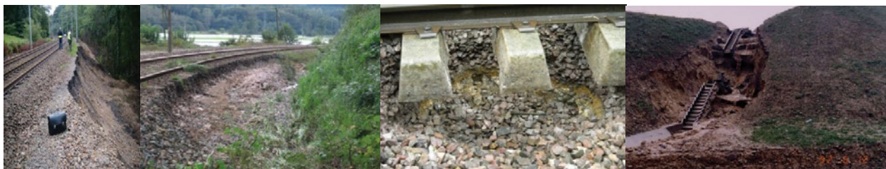
Figure 1 : Illustrations d'incidents graves : érosions de plateforme, de talus ou de remblais (Ingénierie SNCF Infra).
